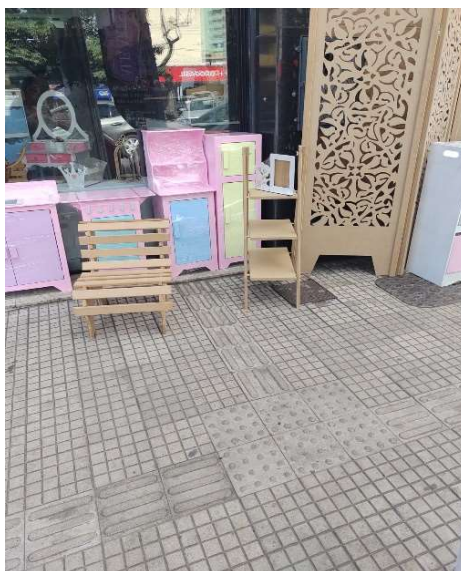
Figura 5: Sinalização tátil e visual de sentido instalados incorretamente
